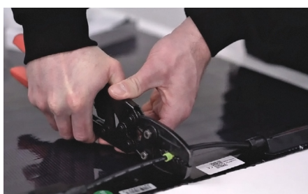
Aurinkopaneelit kytketään latausohjaimen, joka kytketään ajoneuvon akkuun.
